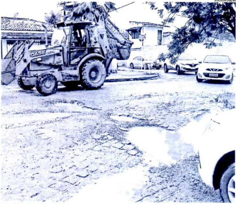
Companhia de Saneamento tem 10 dias para pagar a multa de R$ 2,5 milhões e consertar pavimento das ruas danificadas na capital
